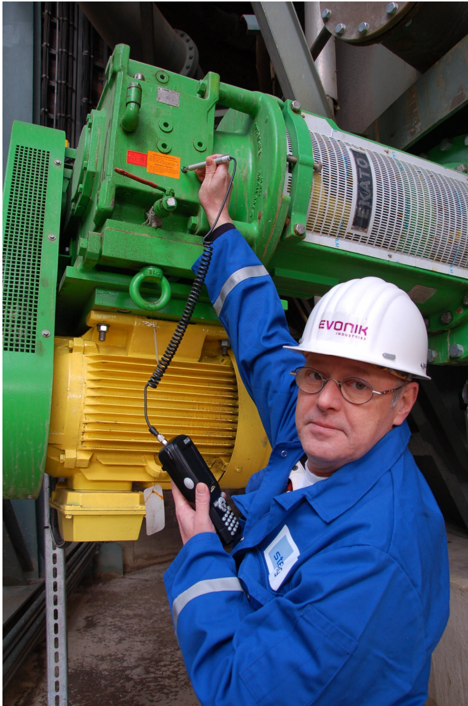
Einsatz von RFID-Chips für die Wartung
